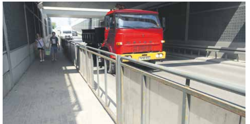
W deszczowe dni zniszczone barierki nie chronią pieszych przed ochlapaniem przez przejeżdżające samochody
