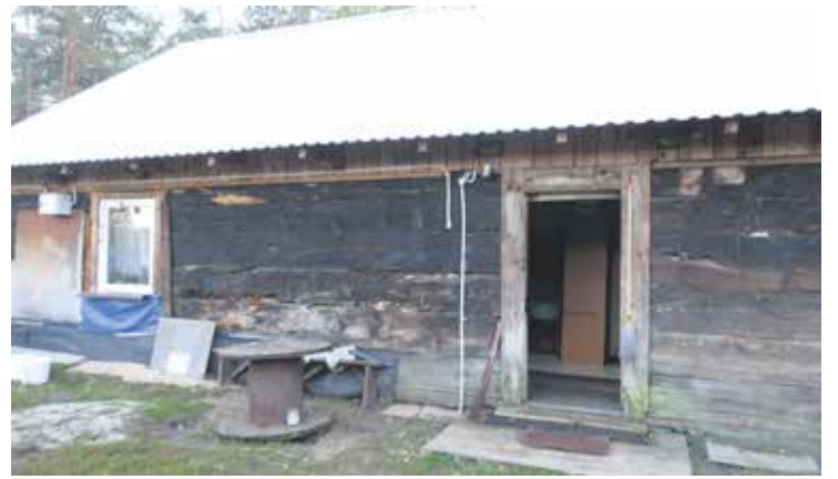
Dom znajduje się w katastrofalnym stanie
