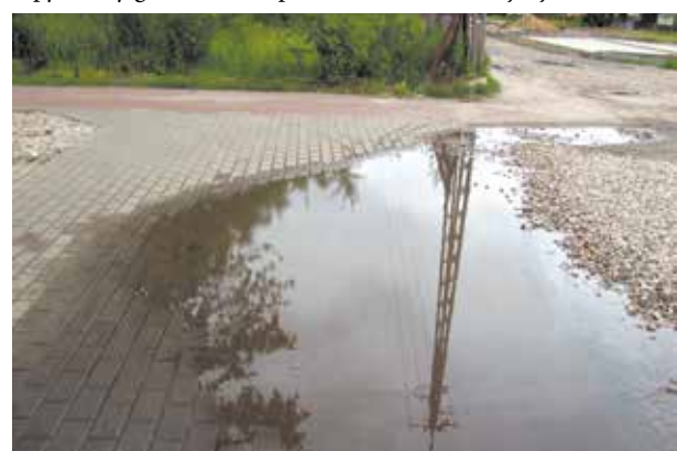
Wyjście z przejścia na ul. Laskową, a raczej w ogromną kałużę na zapadniętym chodniku
