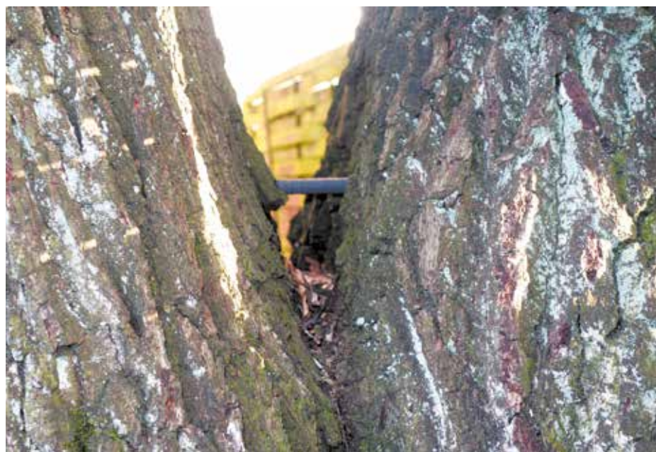
Rozwidlający się pień dębu jest zabetonowany i usztywniony prętami. Czy to wystarczy?
