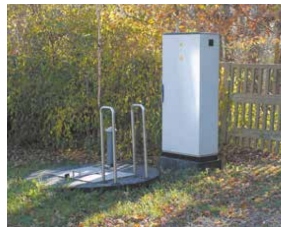
Pompownia ścieków przy ul. Rumuńskiej
